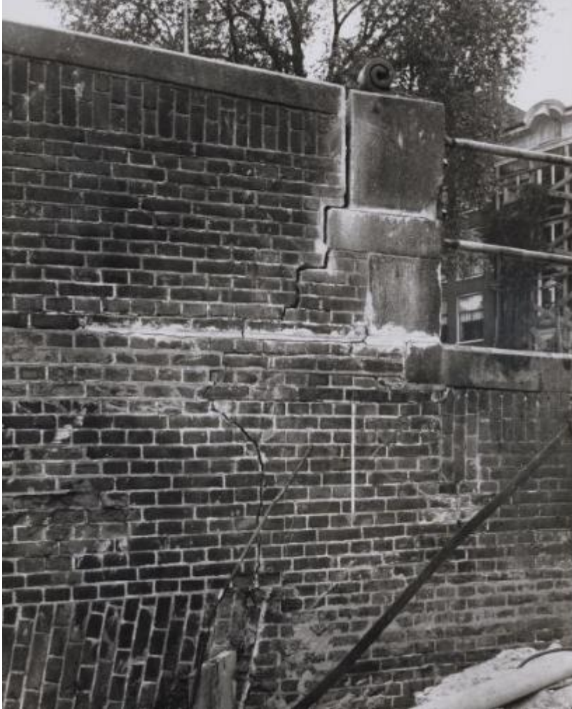
Figuur 129: Foto brug 283 met scheuren op 15 augustus 1977
